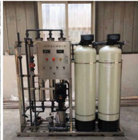
水处理 Water Treatment
